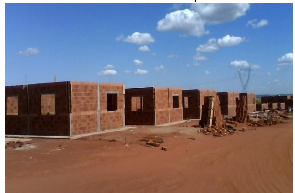
Figura 54: Obras Conjunto Luz da Esperança – S. J. Rio Preto/SP. Fonte: Website da Empresa.
